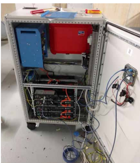
Abb. 1: Schaltschrank vor Integration in den Transporter
